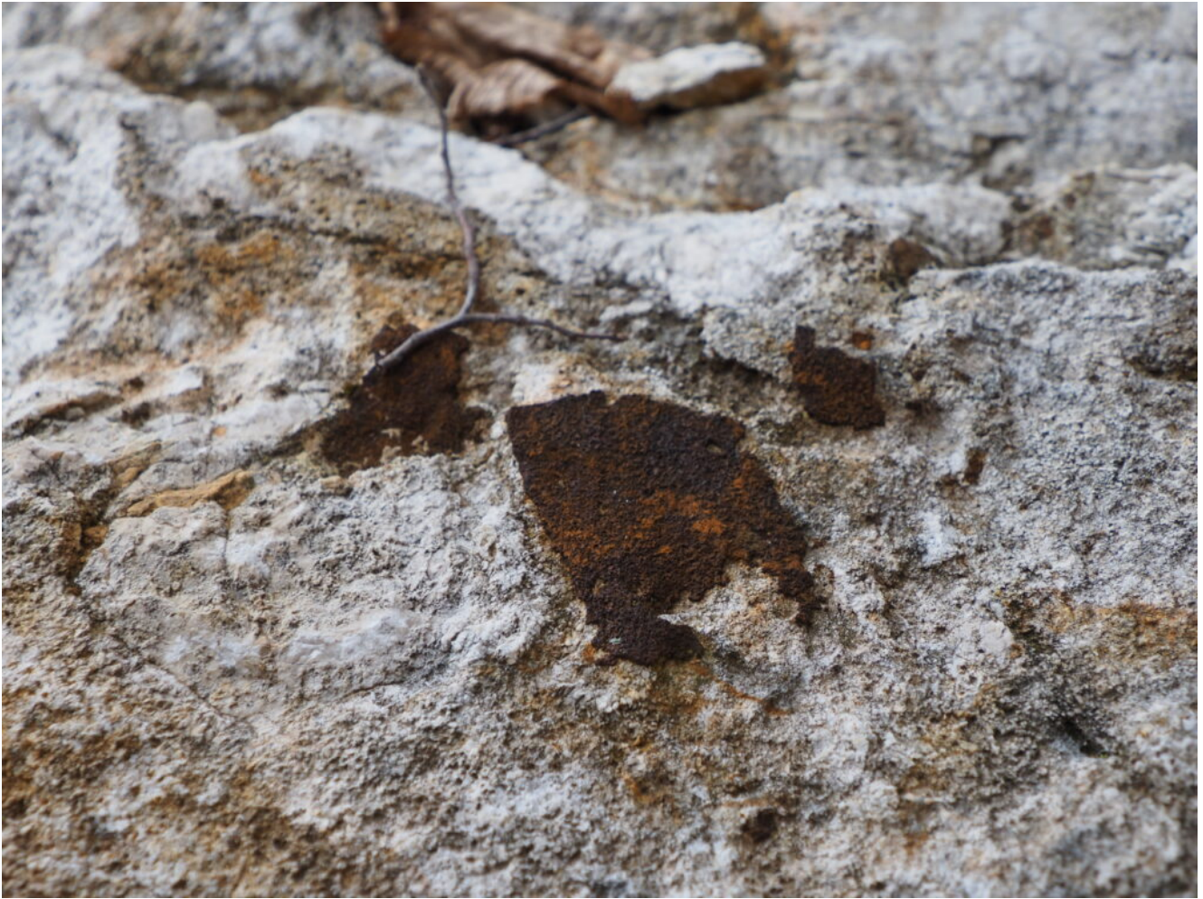
9 - 10 - i massi caduti dalla parete recano spalmature di minerali ferrosi
