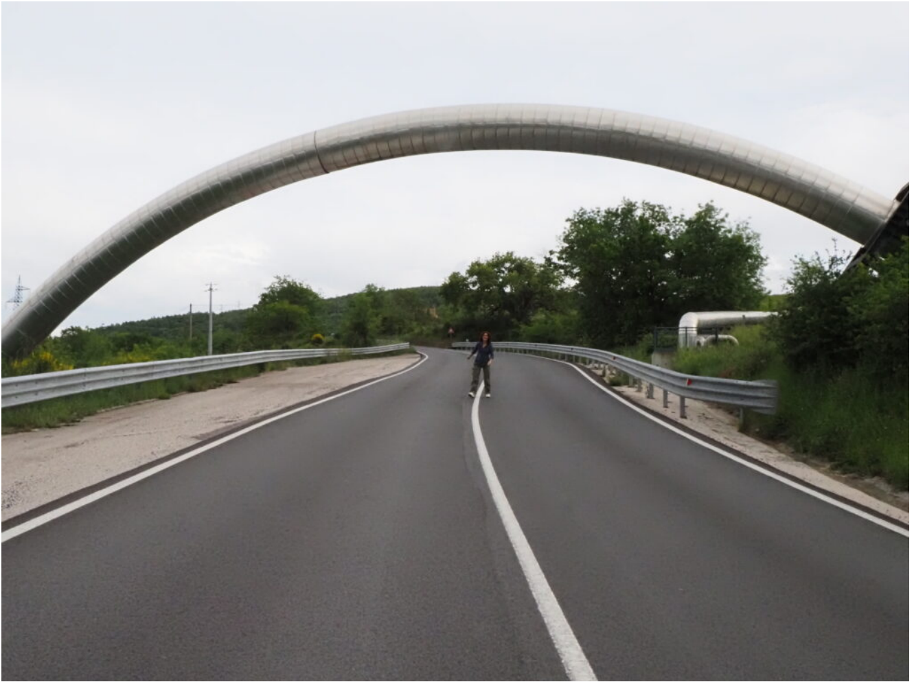
2- Una grande tubazione di vapore attraversa la strada nei pressi di Sasso Pisano.
