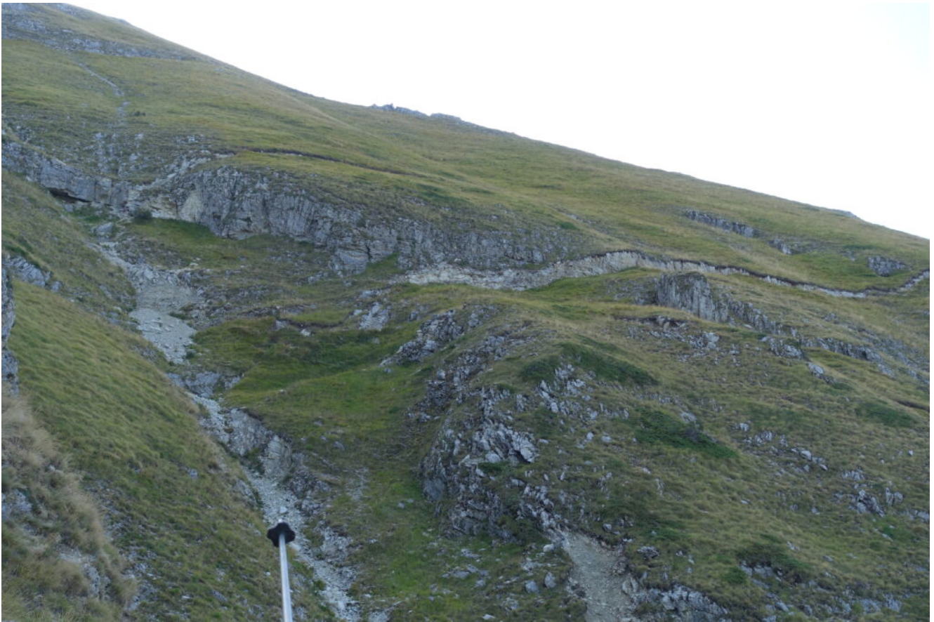
12- Guardando in alto si osserva la zona spaccata dal sisma del 2016 e la relativa faglia (riga bianca) che ha subito un abbassamento di quasi due metri.
