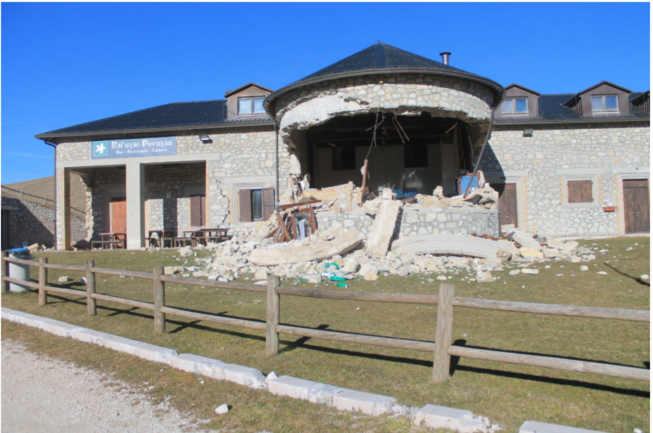
9- Il Rifugio Perugia, l'evidente errore costruttivo di un pesante cordolo in cemento armato sopra un muro di pietre non
