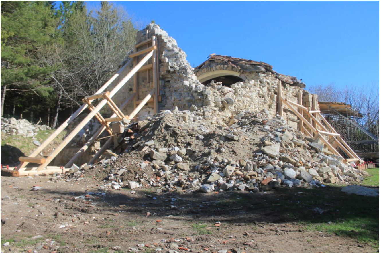
3- Veduta laterale di ciò che rimane della chiesa.
