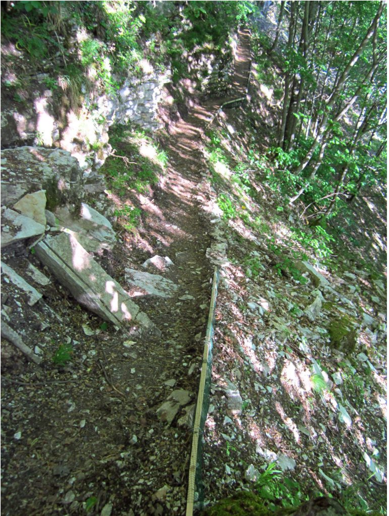
2- Opere di contenimento nel sentiero Bolognola-Cascate dell'Acquasanta realizzate con una semplice tavola in un ripido pendio soggetto a slavine.
