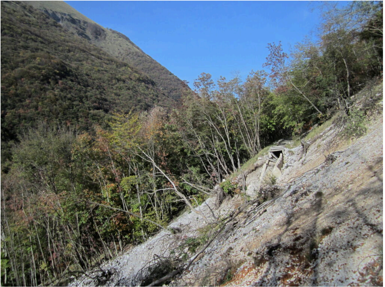
6- La grande frana che ha interrotto il canale, visibile a destra.
